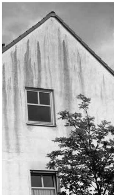
図6：軒の突き出し部が少ないため、藻が繁殖しているファサード 出典：Keimfarben GmbH社 www.keimfarben.de
