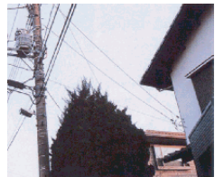
OV、DV架線状況
