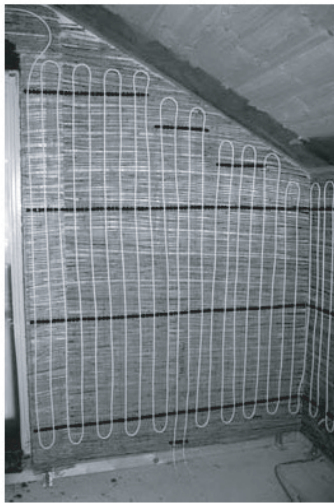
図21 ポリプロピレン管を塗り下地材であるアシボードに留めた壁暖房 (配管は土モルタル、石灰モルタルなどで塗りこむ)
