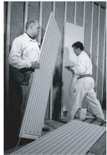
図23 混合管を仕込んである石膏繊維板を用いた壁暖房 (ボードは実になっていて、上塗りして仕上げる)
